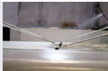
03. Aplicación de la capa de barrera química de alta resistencia para la prevención de ósmosis
